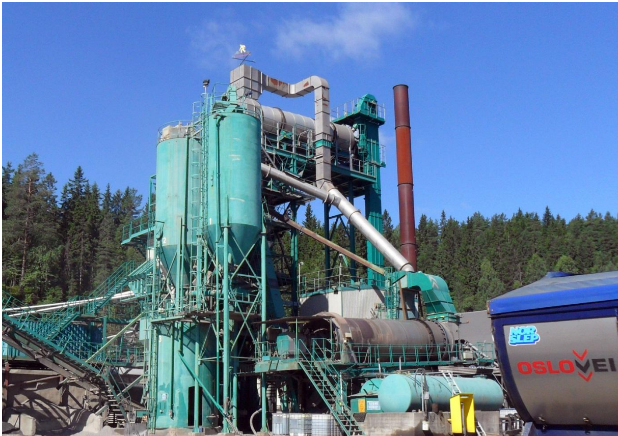
Bilde 9.3 Asfaltfabrikk med egen gjenbrukstrommel
