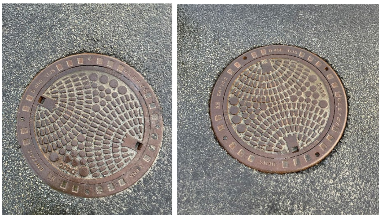
Bilder av kummer med dårlig tetting inntil kumrammer
